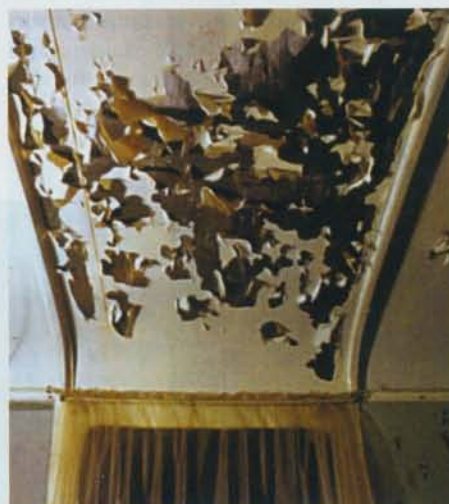
Auch das geht: Die Wiederherstellung des Lacks im Innenraum, der nur noch in Fetzen vom Dach hinunter hing. Die Restaurierung...
