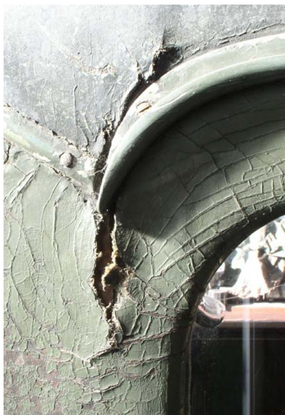
Foto 2: Karosserie hinten rechts; Übergang Dach, C-Säule; Vorzustand
